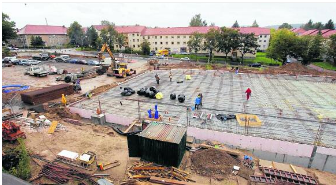
Das Sonnenhof-Areal auf dem Zeller Berg in Aue ist derzeit eine Großbaustelle. Hier errichtet der Lebensmittelkonzern Lidl einen neuen Einkaufsmarkt. —FOTO: LARS ROSENKRANZ
